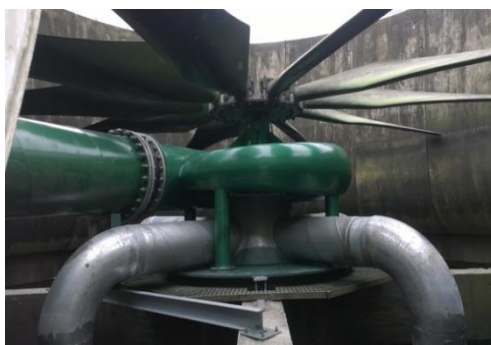
图 1 冷却塔专用水轮机现场照片
